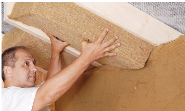
Der Einbau von Dämmmatten aus Hanf in einem Dach. (Bild: Thermo-Natur / stroba-naturbaustoffe ag)
